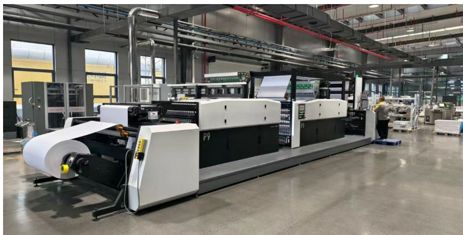
图片说明：河南盛大印刷于 2025 年 1 月安装的第一台 P9 大龙卷生产现场
